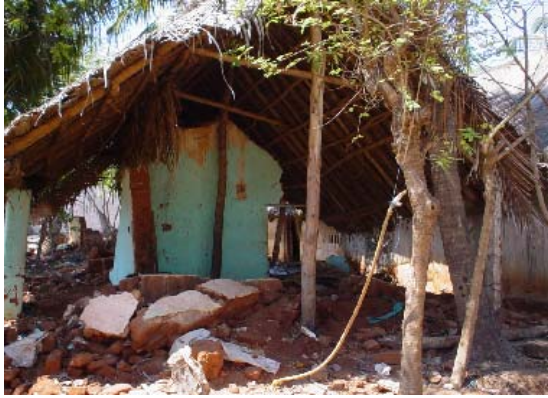
図 6-2-5-1 被災した漁民の家 (ポンディチェリー連邦直轄地)
