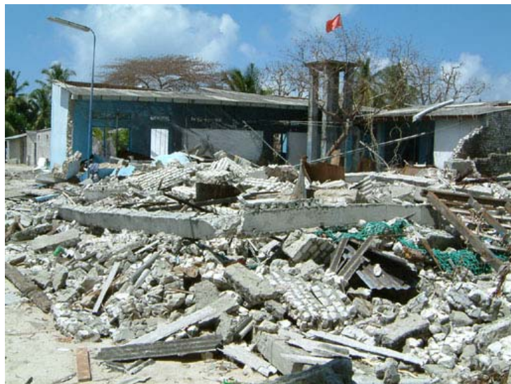
図 6-2-4-3 ター環礁ヴィルフシ島の倒壊建物
