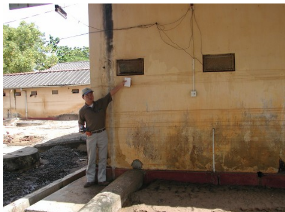
図 6-2-1-2 被災病院の壁面の水跡（トリンコマリー）
