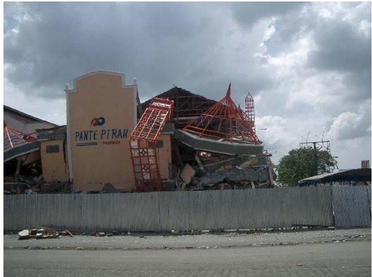
図 6-2-3-1 バンダアチェ市内の地震による被害
